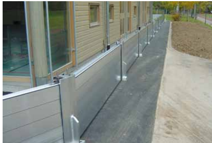
Umlaufender Hochwasserschutz mit teilmobilen Schutzelementen
